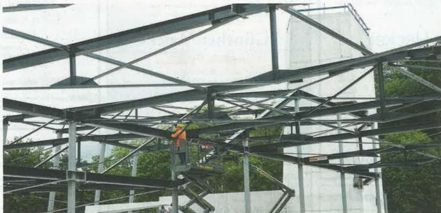
Ein Monteur von Stahlbau Nägele verbindet die einzelnen Elemente der eindrucksvollen Stahlkonstruktion.
