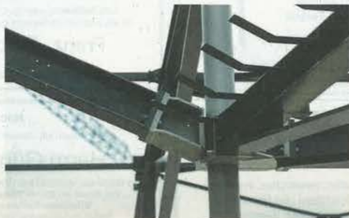
An der Verbindungsstelle muss alles passgenau sitzen – hier zeigt sich die individuelle Handwerkskunst im Stahlbau.
